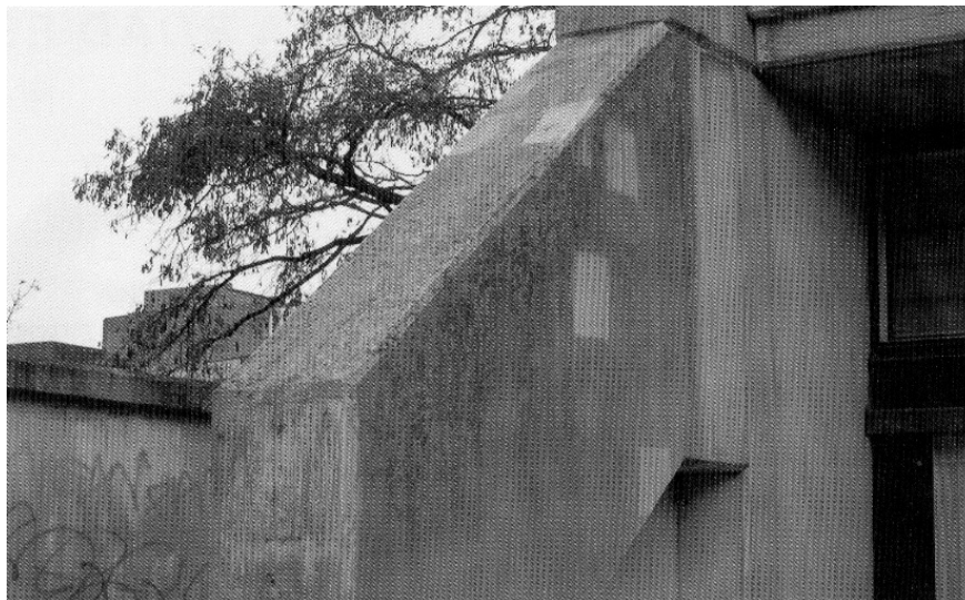
FIGURA 7 – Reparos iniciais (retângulos), contrastando com o concreto original, decorridos 10 anos.
