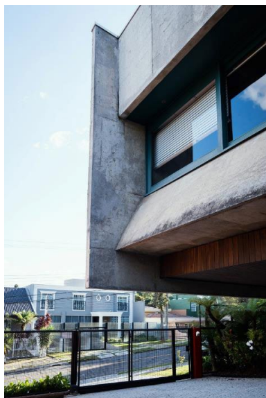
FIGURA 2 e 3 – Detalhes do encontro da empena frontal e fachada lateral da residência Maria Nadir de Carvalho (1975)
