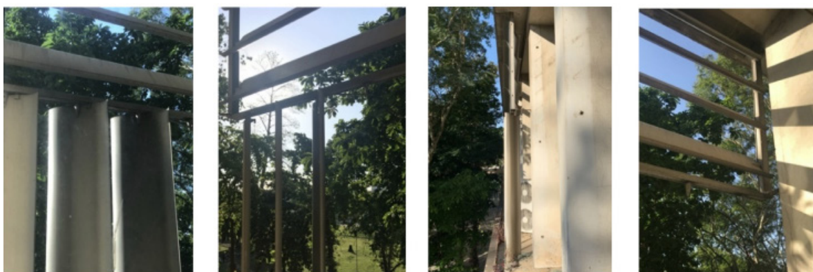
FIGURA 8 – Resquícios dos protótipos dos brises instalados na fachada
