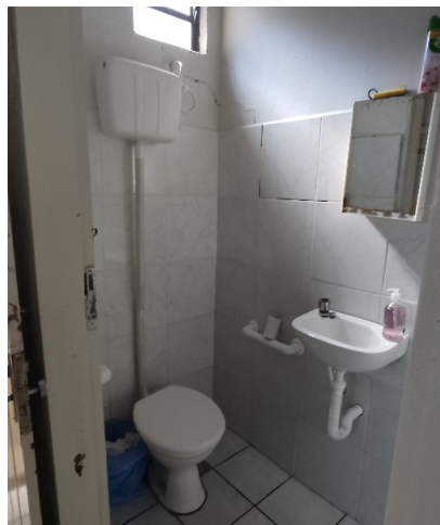
FIGURA 8 - Sanitário da UFVP
