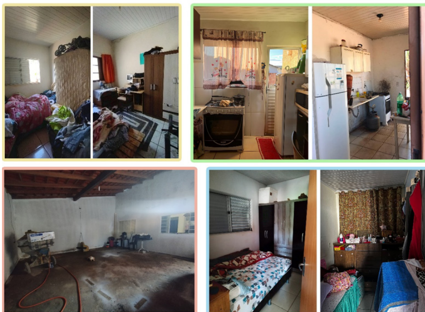
FIGURA 10– Problemas construtivos nos conjuntos habitacionais estudados.
