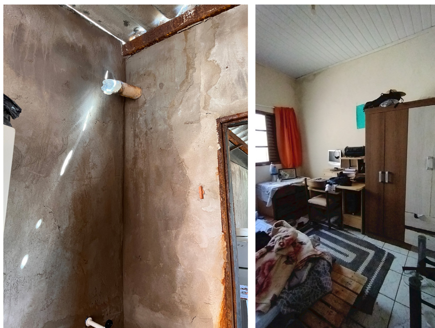
FIGURA 7- Infiltrações Registradas no R2A4 (esquerda) e RSB (direita).
