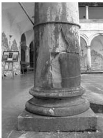
FIGURA 3 - Coluna com fortes sinais de degradação
